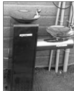
Un nouvel abreuvoir vient d'y être installé.
